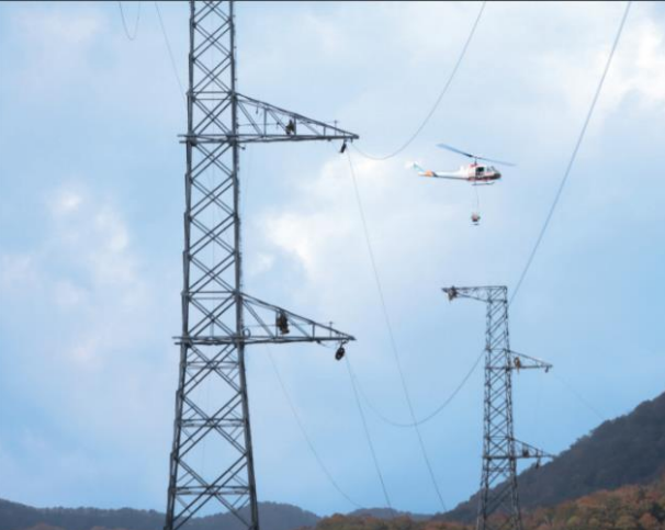
新北本 直流送電線（架空部）
