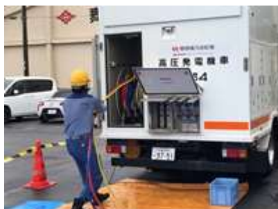
第八管区との電源供給訓練
