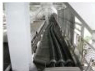
本四連系線 〔瀬戸大橋に敷設の ケーブル区間〕
