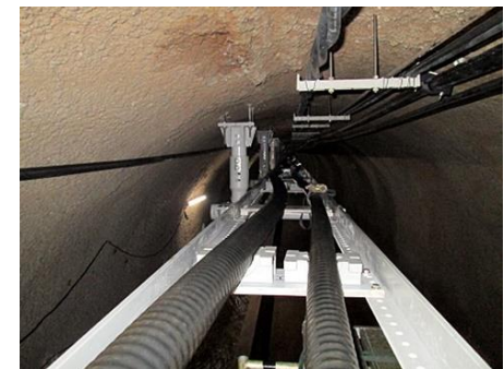
新北本ルート 直流送電線（地中部）
