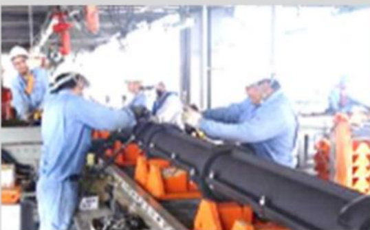
1. ①従来の敷設船上でのケーブル防護管取付例 (本事業で自動化・高速化の開発を予定)
