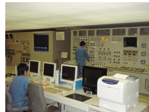
中央操作室での監視状況
