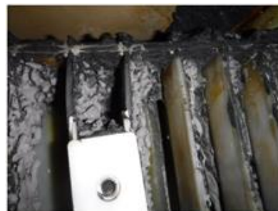
清掃前 (付着物により金属製の板の隙間が狭まっている)
