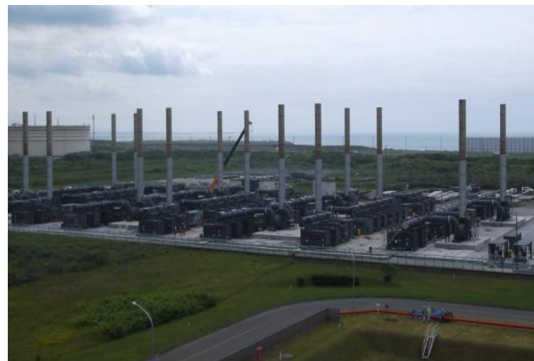
【緊急設置電源（苫小牧発電所）】
