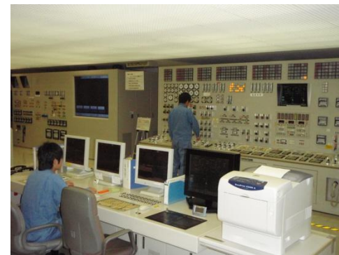
中央操作室での監視状況
