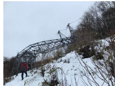
紋別東線No152 鉄塔倒壊（紋別市）
